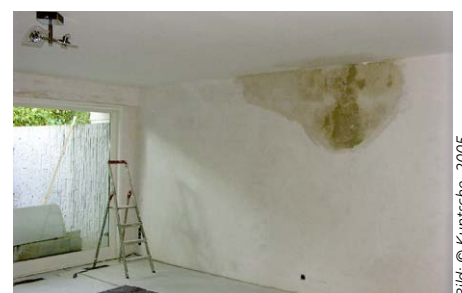
(1) Nässeschaden in einer Souterrain-Wohnung
